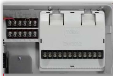
Configuration 16 voies avec 1 module de 12 voies
